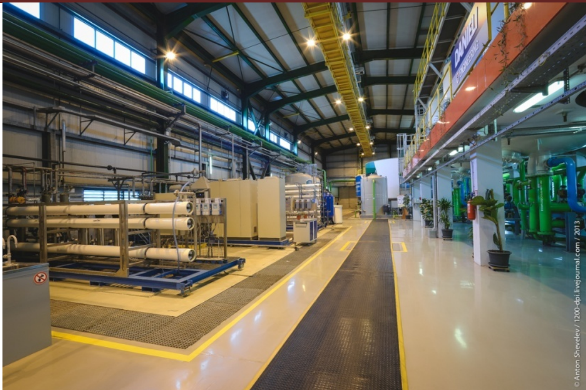
Рис. 3 – Установка зворотного осмосу
