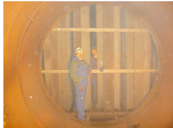
Рисунок 2 Установка аппарата инерционного осаждения «VAV-250-АФК» в газовый коллектор агломашины № 12 ПАО «Днепропетровский меткомбинат»
